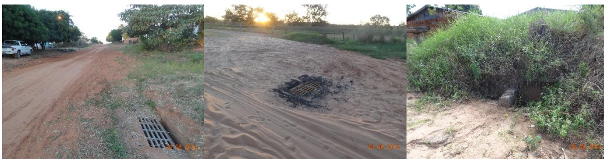
Figura 105 – Dispositivos de drenagem de águas pluviais em vias não pavimentadas que carregam grande quantidade de sedimentos no município de Alcinópolis/MS.
