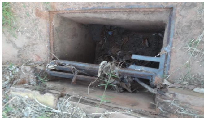
Figura 107 – Boca de lobo danificada sem grelha encontrada no município de Alcinópolis/MS.
