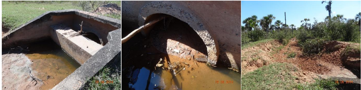
Figura 113 – Dispositivo de lançamento de águas pluviais no Ribeirão do Retiro em Alcinópolis/MS.
