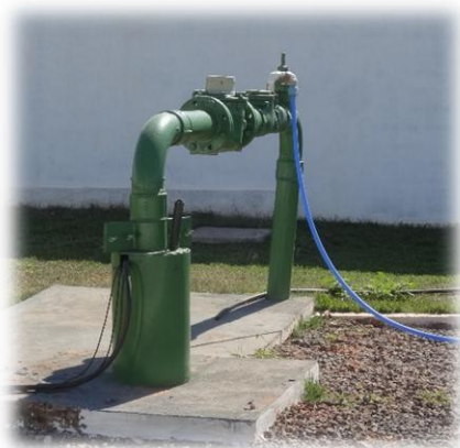
Figura 43 – Detalhes do Poço tubular profundo ALC-005.
