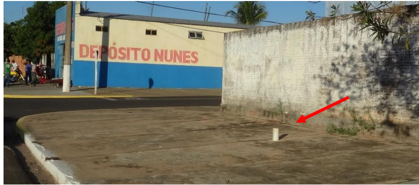
Figura 51 – Fossa instalada no espaço destinado a calçada em Alcinópolis/MS
