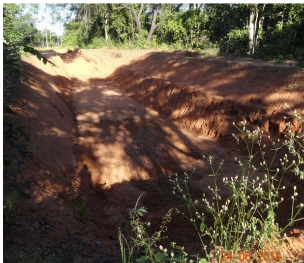
Figura 67 – Construção da célula funcional como solução emergencial para o município de Alcinoópolis/MS.
