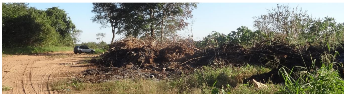
Figura 93 – Terceira área de passivo ambiental – Área da futura Unidade de Gerenciamento de Resíduos Sólidos (Aterro de inertes) de Alcinópolis/MS.
