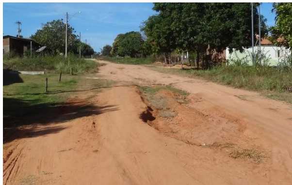
Figura 135 – Problemas das vias do Distrito Novo Belo Horizonte devido à enxurradas.
