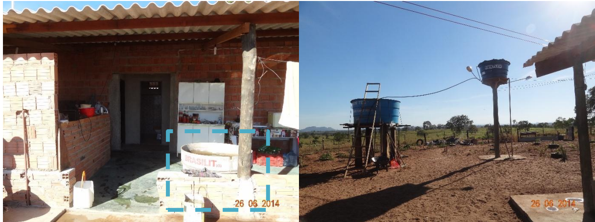
Figura 125 – Propriedade que utiliza poço escavado com bomba com reservação em caixas d'água elevadas e caixa d'água para reservação da água do poço comunitário no Assentamento Santa Fé.
