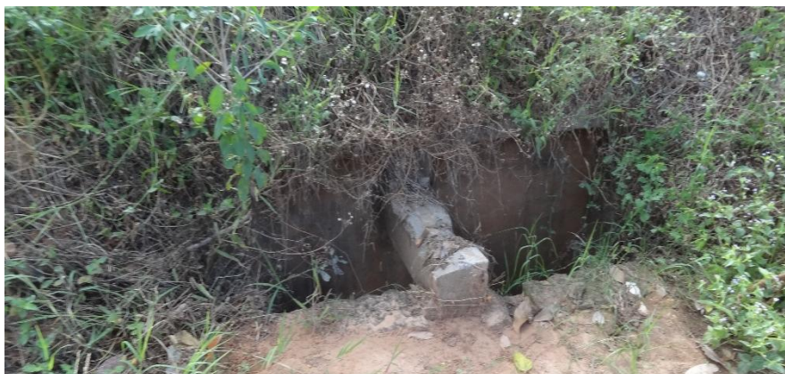
Figura 111 – Caixa coletora do sistema de macrodrenagem de águas pluviais localizada na Rua Olegário Barbosa da Silveira do município de Alcinópolis/MS.
