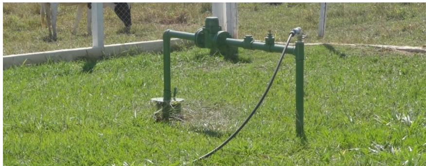
Figura 36 – Detalhes do Poço Tubular Profundo ALC-002
