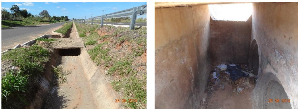
Figura 103 – Dispositivo de drenagem presente na Rodovia BR 359/Avenida Joaquim Pereira França com a presença de material retido e acúmulo de resíduos em seu interior.
