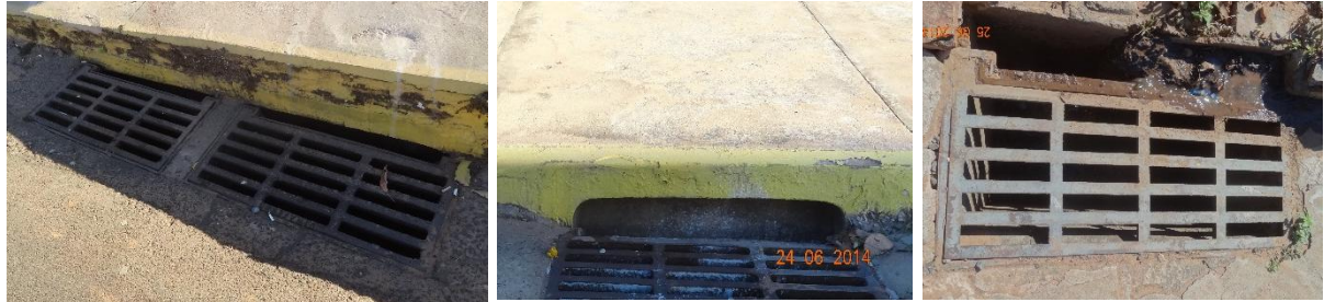
Figura 102 – Tipos de caixas coletoras (bocas de lobo) do município de Alcinópolis/MS.
