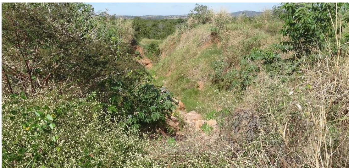
Figura 98 – Área em processo de degradação com pontos de erosão no local do dispositivo de escoamento de águas pluviais.
