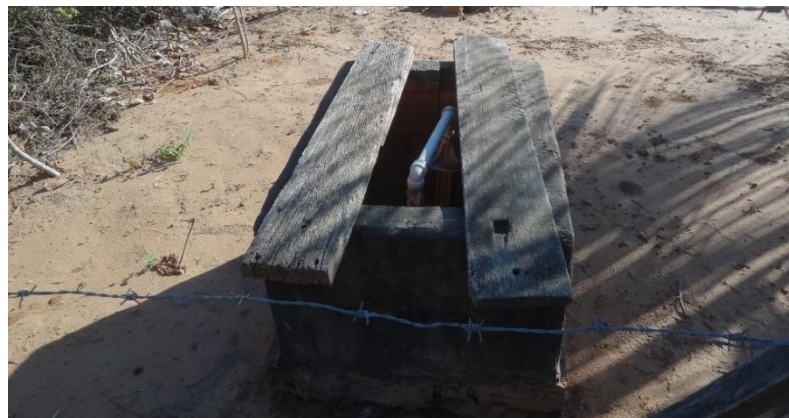
Figura 124 – Cavalete para a medição de água sem hidrômetro encontrado no Distrito Novo Belo Horizonte – Alcinópolis/MS.
