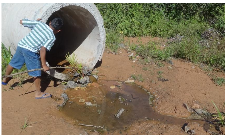
Figura 117 – Dispositivo de lançamento de águas pluviais recentemente implantado em Alcinópolis/MS.
