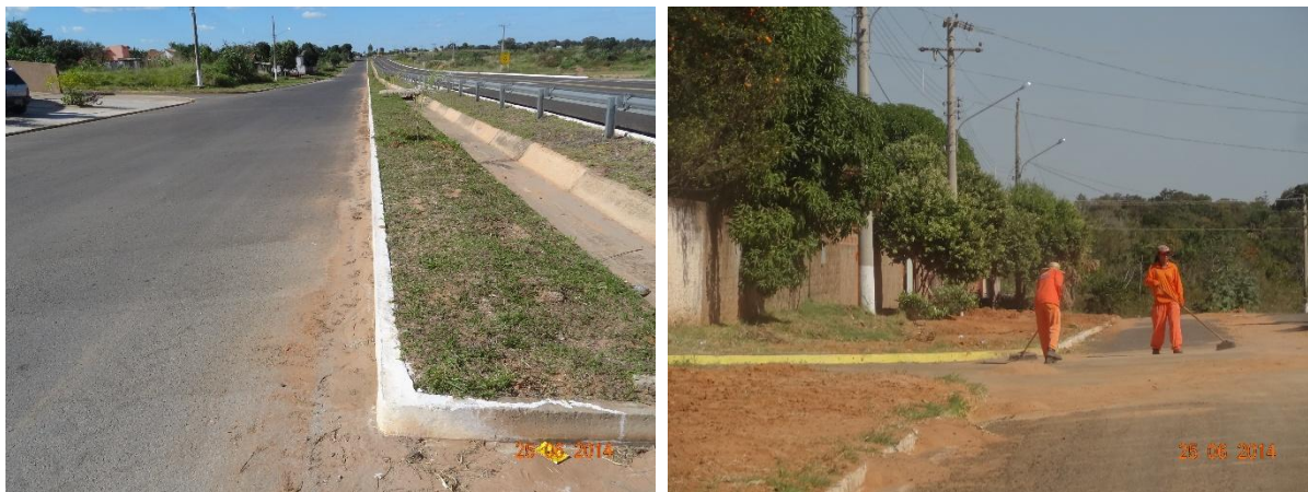
Figura 100 - Acúmulo de sedimentos nas sarjetas em algumas vias do município de Alcínópolis/MS.
