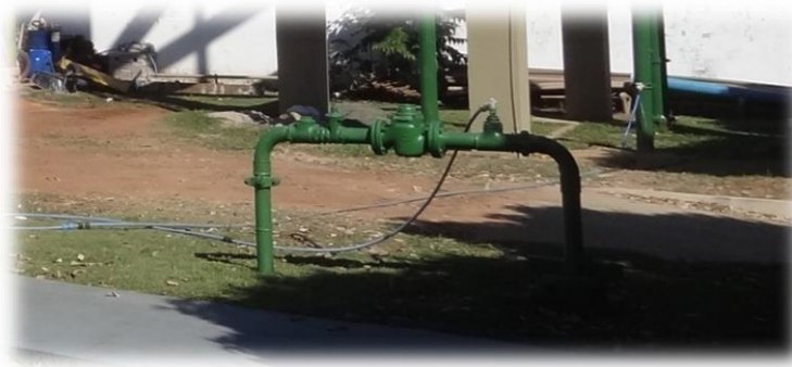
Figura 38 – Detalhes do Poço tubular profundo ALC-003.
